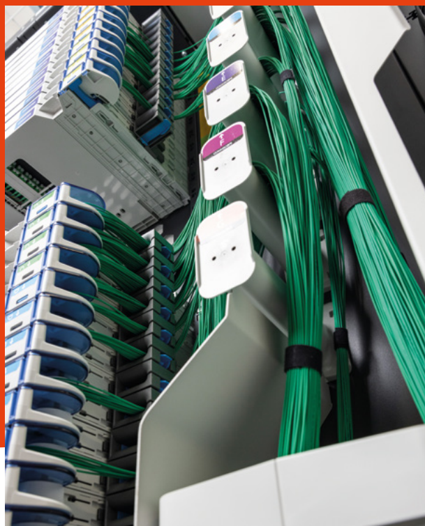
Glasfaserverteilstelle für unsere Provider
