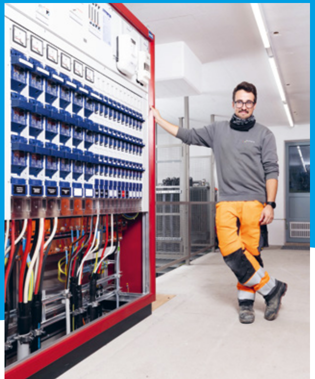
Blick in die 2022 sanierte Trafostation Wenkenrüti.
